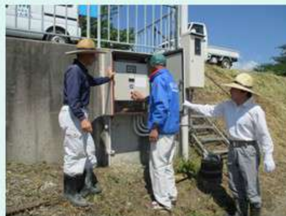
西面集落ポンプ点検 (令和元年 5月22日実施)
