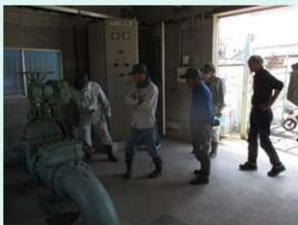
唐崎集落ポンプ点検 (平成31年 4月25日実施)
